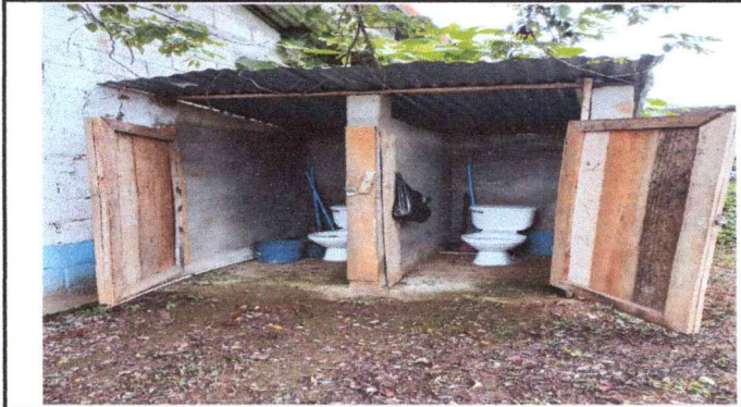
Foto1: A consecuencia el piso esta agrietado
