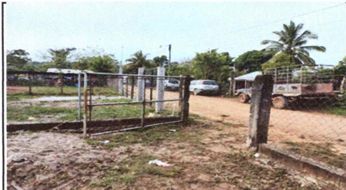
Foto 3: Porton el mal estados y oxidados
